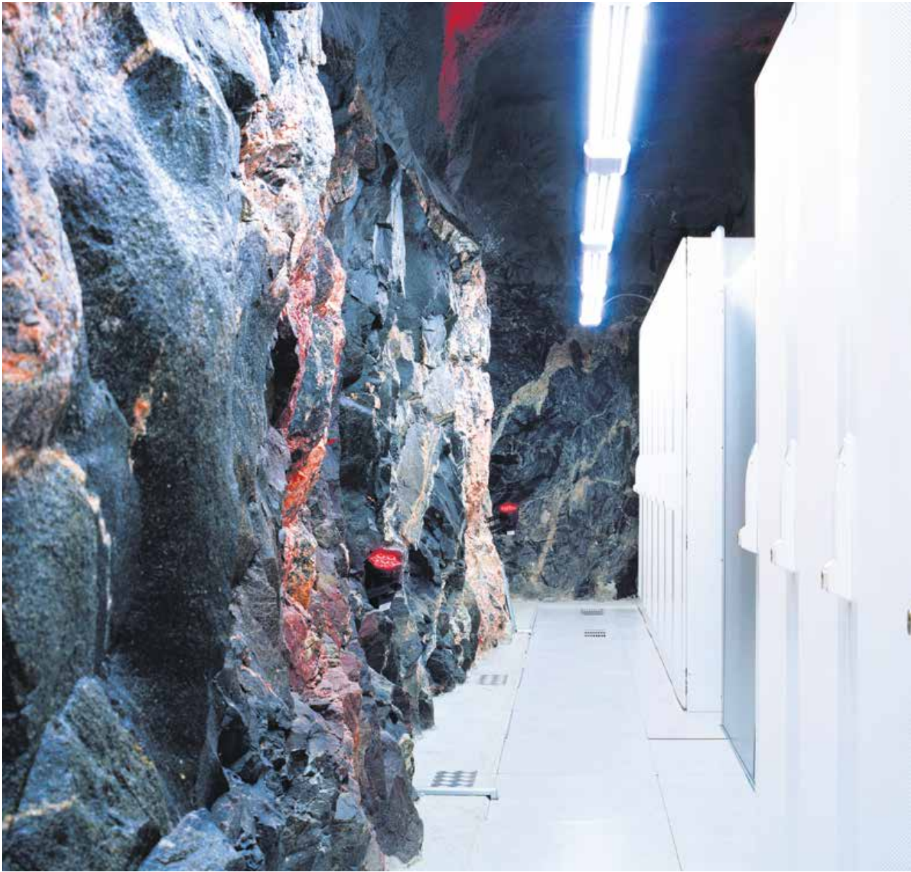
Het datacenter van WikiLeaks in het Zweedse Pionen, een voormalige bunker van defensie, die tijdens de Tweede Wereldoorlog werd gebouwd.
